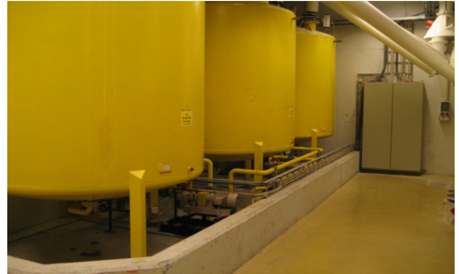
Lagertanker for kjemikalier er sikret mot utslipp
